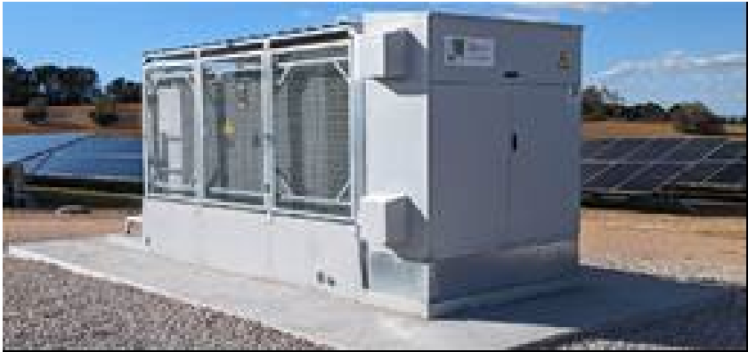
Figura 35. Exemple de Centre de Transformació 25/0,8 kV de 1,9 MVA de potència
