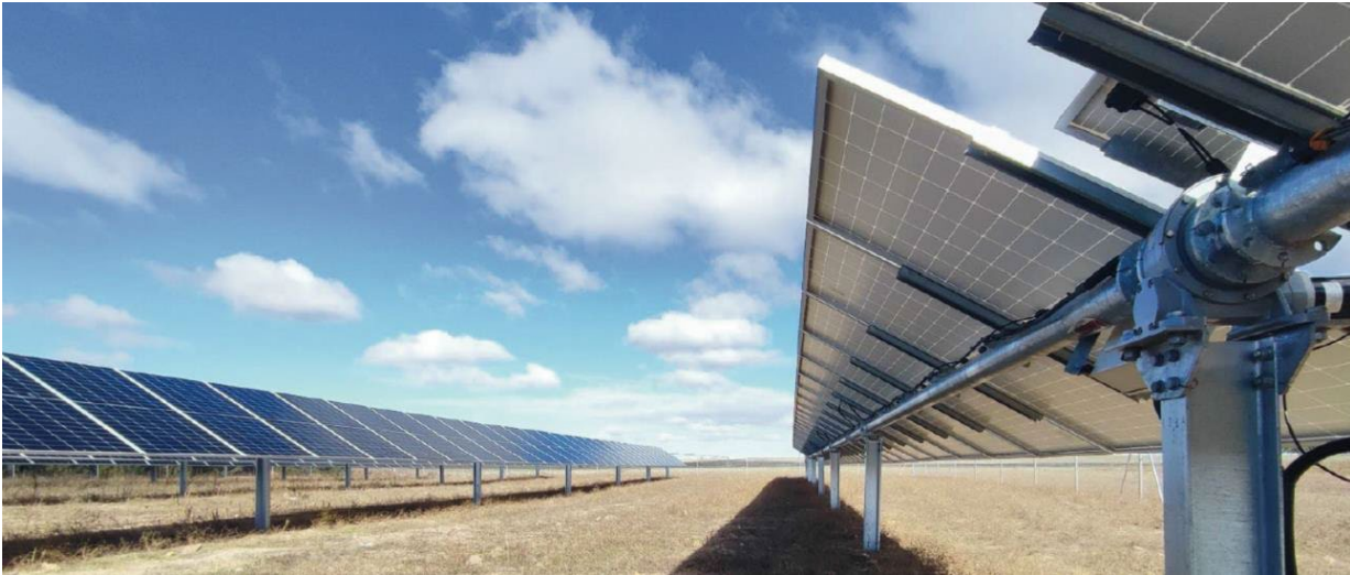
Figura 34. Exemple d'estructura de panells fotovoltaics amb seguidor
