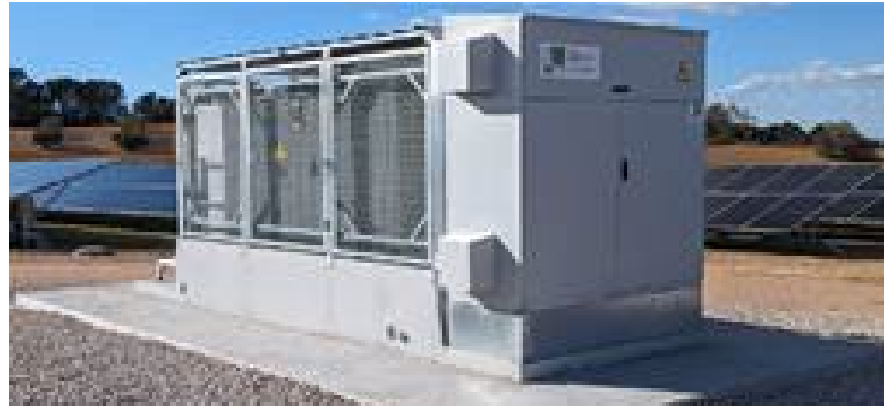
Figura 13. Exemple de Centre de Transformació 25/0,8 kV de 1,9 MVA de potència
